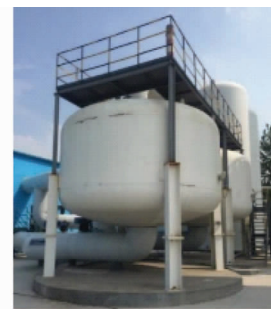
图 6 玻纤制氧系统吸附塔
