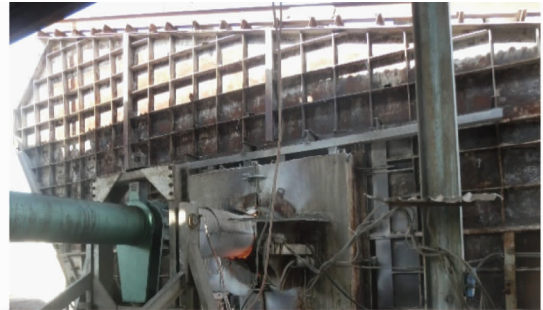
图 5 水泥厂窑头燃烧器
