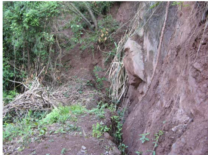
图 5-44 滑坡后缘裂缝
