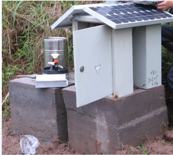
图 5-58 雨量计和附属设施现场图
