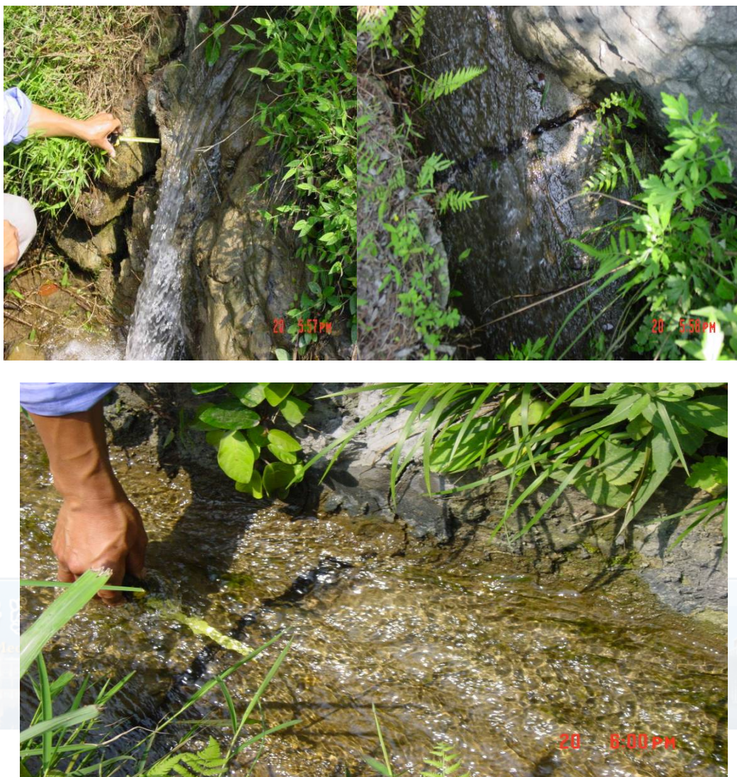
图 4-7 水沟中宽窄不一的裂缝
