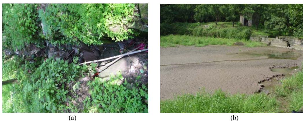
图 1-1 晒网坝滑坡: (a)滑坡表面的裂隙; (b)池塘水沿着裂隙全部渗入坡体内部
