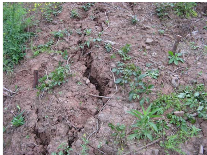
图 5-45 滑坡中部鼓胀裂缝
