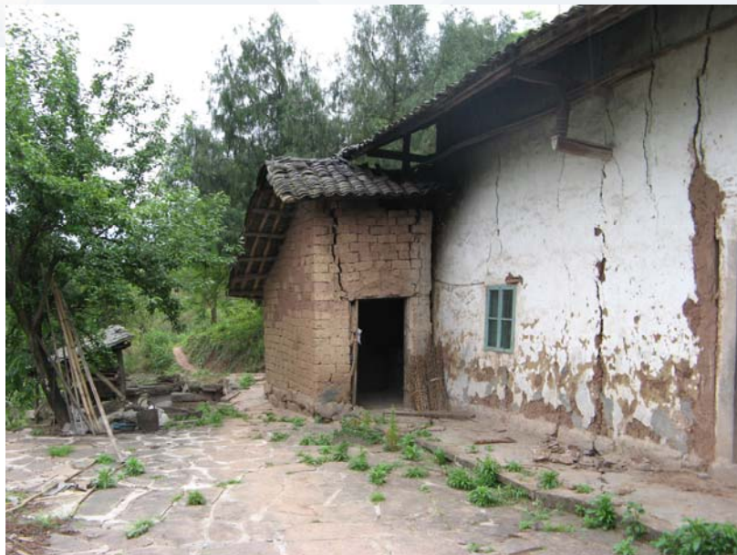
图 5-3 房屋破坏情况
