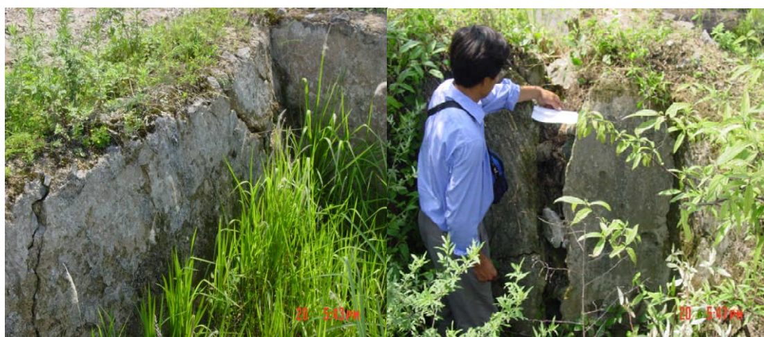
图 4-6 覃守运老房下方水池边缘明显前凸并开裂，裂缝最宽处超过 20cm
