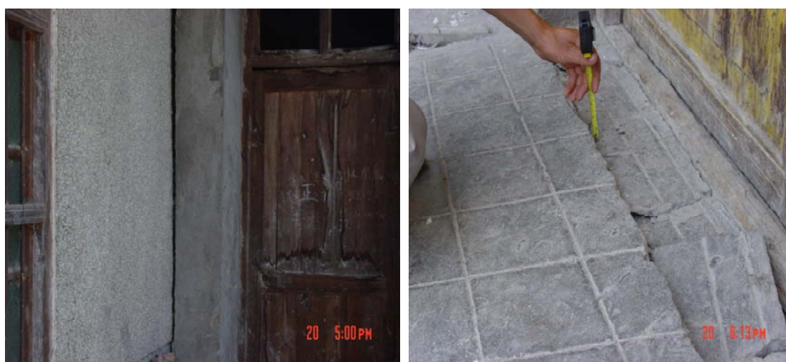
图 4-8 覃守运老房与竖井之间的房屋墙壁开裂、地面错动
