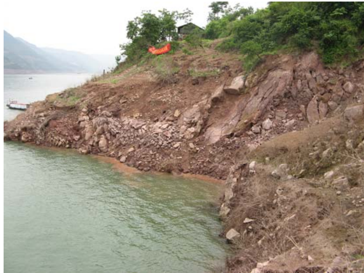
图 5-43 滑坡前缘塌岸
